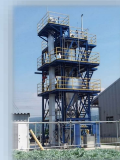
BLUE タワー II 2013 第3号実証プラント (群馬県渋川市)
